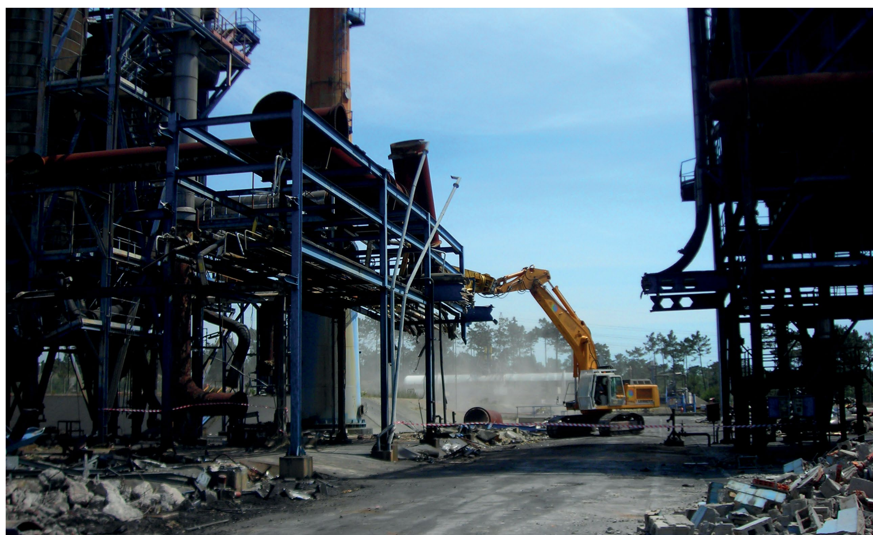
Trabajos de desmantelamiento de una planta industrial - desmantelamiento de infraestructuras técnicas y equipos.
