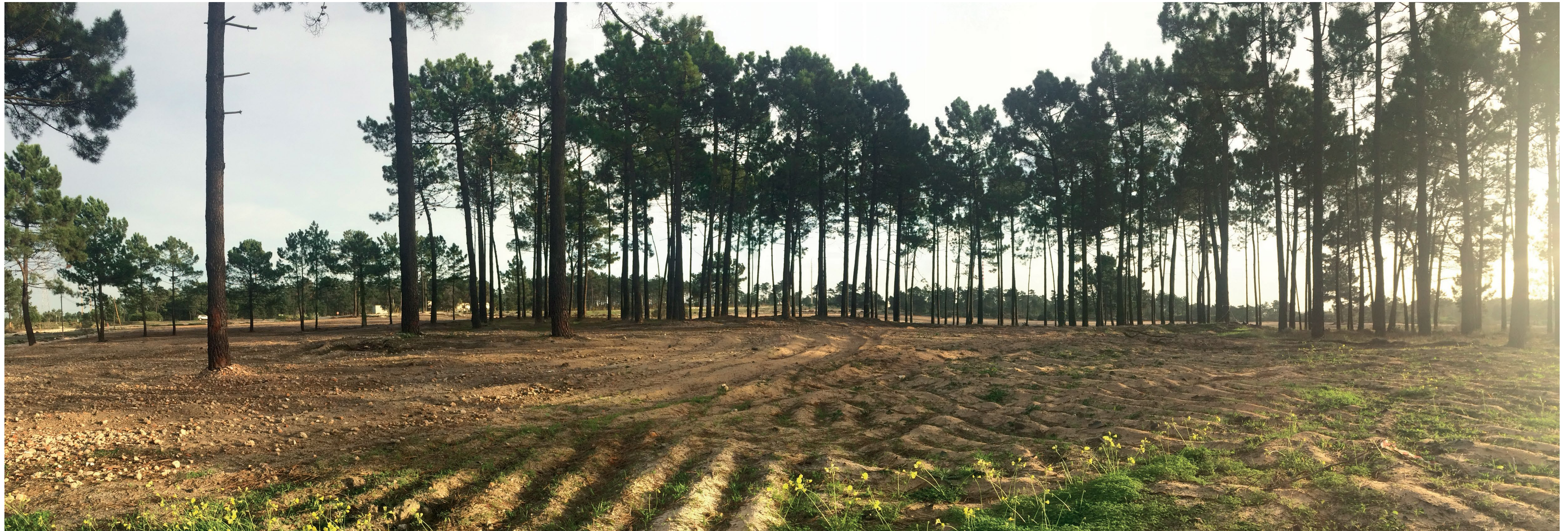
Vista general de un emplazamiento tras la conclusión de los trabajos de desmantelamiento y demolición.
